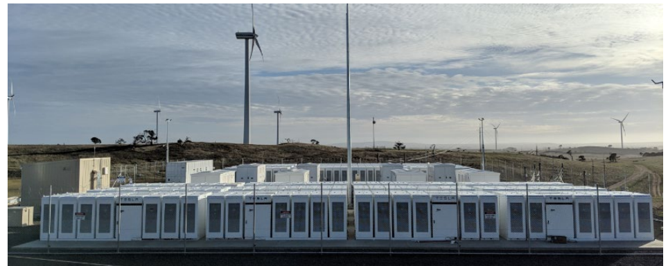
Lake Bonney Battery Energy Storage System, SA
