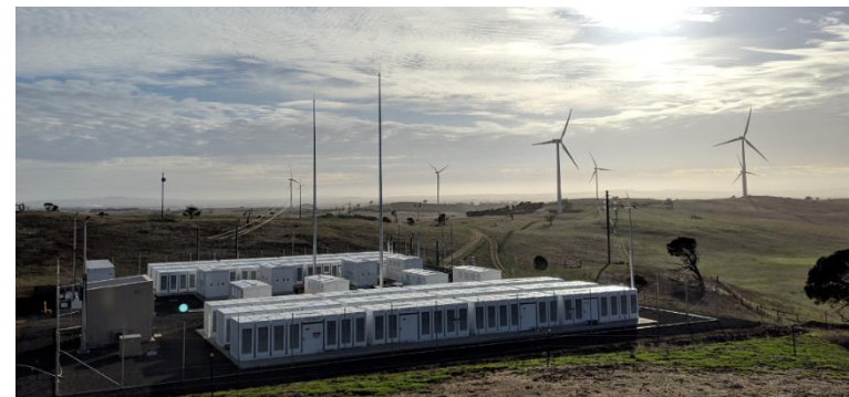
Lake Bonney Battery Energy Storage System, SA
