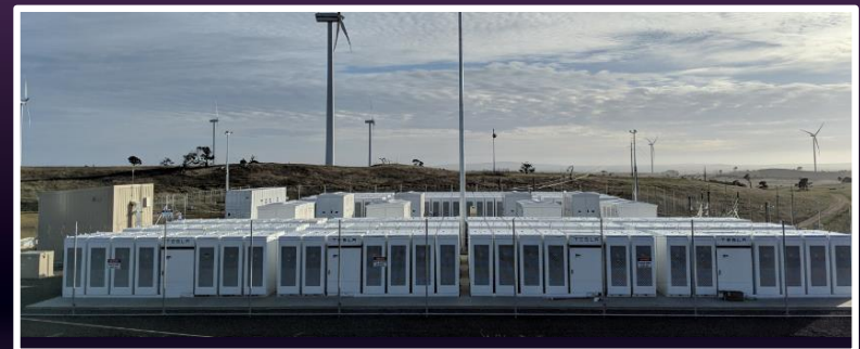
Lake Bonney Battery Energy Storage System, SA
