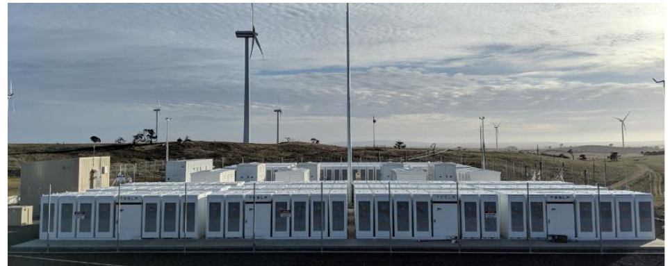
Lake Bonney Battery Energy Storage System, SA
